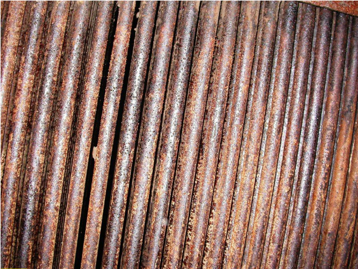
Bild 4: Öl ECO, Blick von oben, starke Korrosion die Material abzehrt, die Oberfläche wird sehr rau und danach schneller verschmutzt
