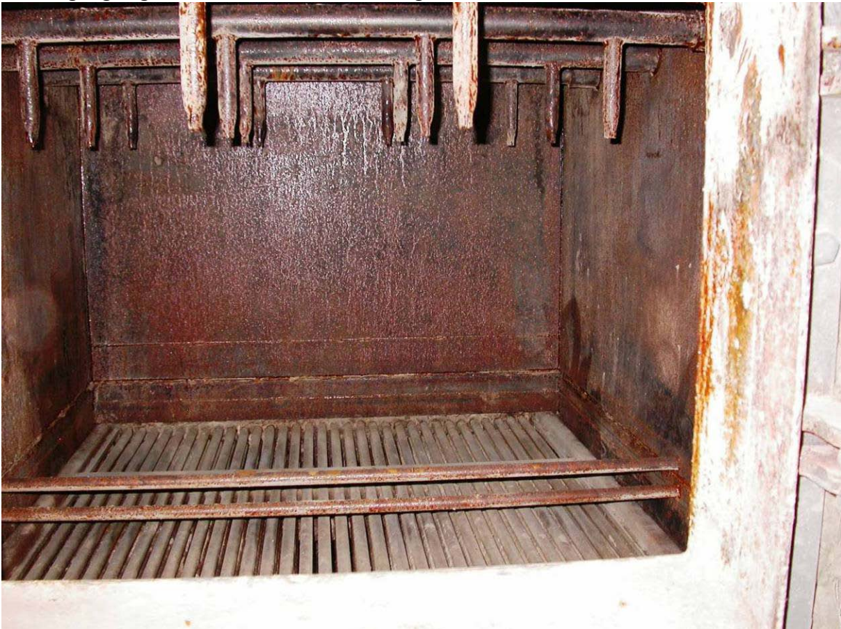
Bild 3: Öl ECO nach Reinigung mit Wasser, sämtliche Flächen extrem korrodiert
